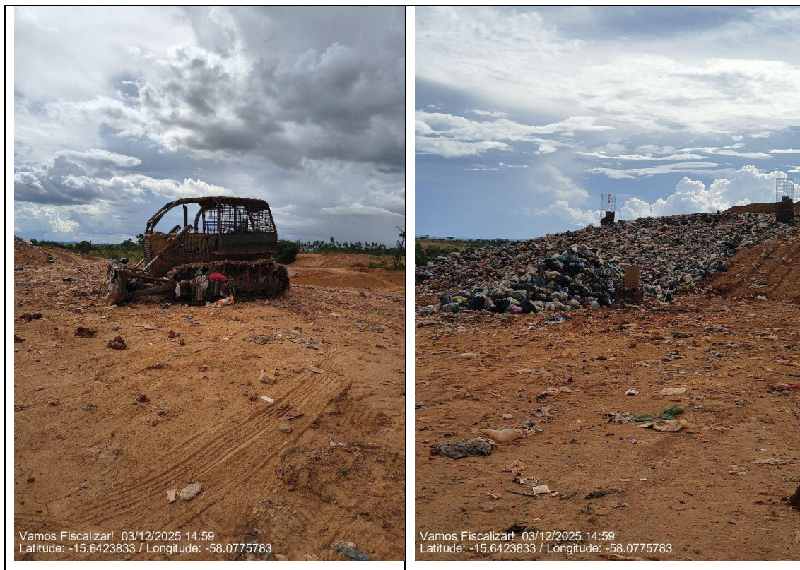
Figura 9 - FONTE: Fiscalização Agerr Pantanal (2025).
