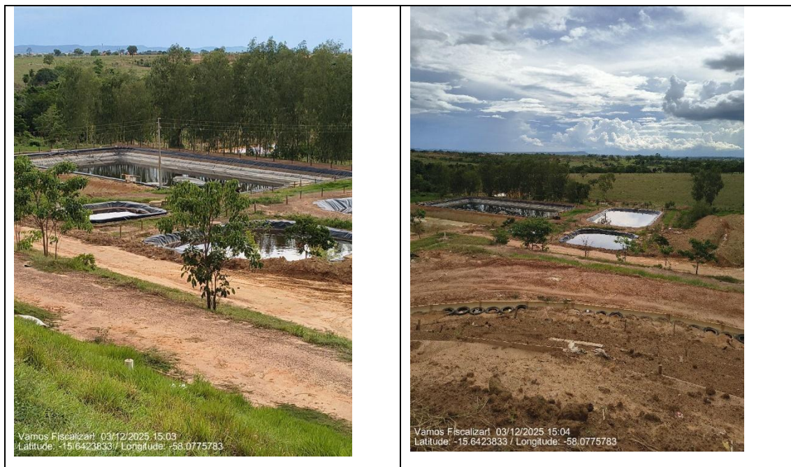
Figura 11 - FONTE: Fiscalização Agerr Pantanal (2025).
