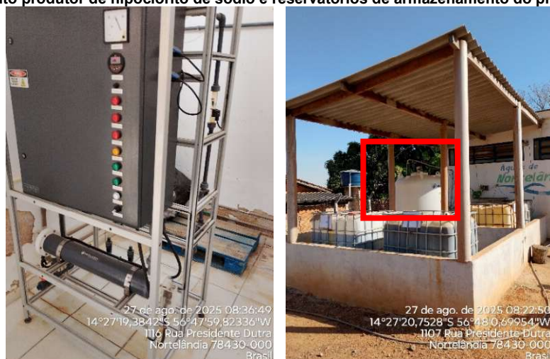
Figura 4: Equipamento produtor de hipoclorito de sódio e reservatórios de armazenamento do produto químico.
