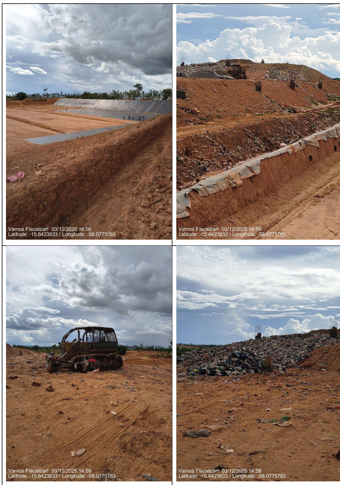
Figura 9 - FONTE: Fiscalização Agerr Pantanal (2025).
