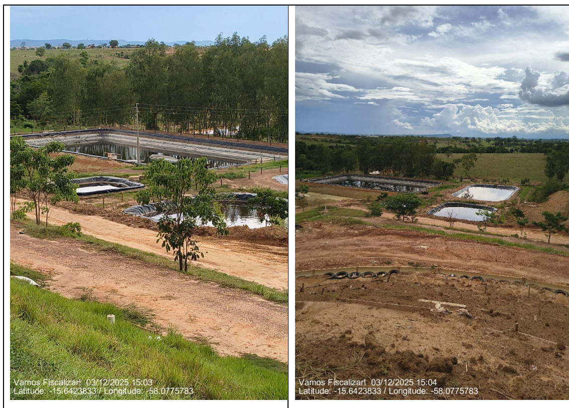
Figura 11 - FONTE: Fiscalização Agerr Pantanal (2025).
