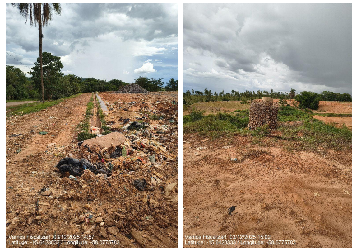
Figura 10 - FONTE: Fiscalização Agerr Pantanal (2025).
