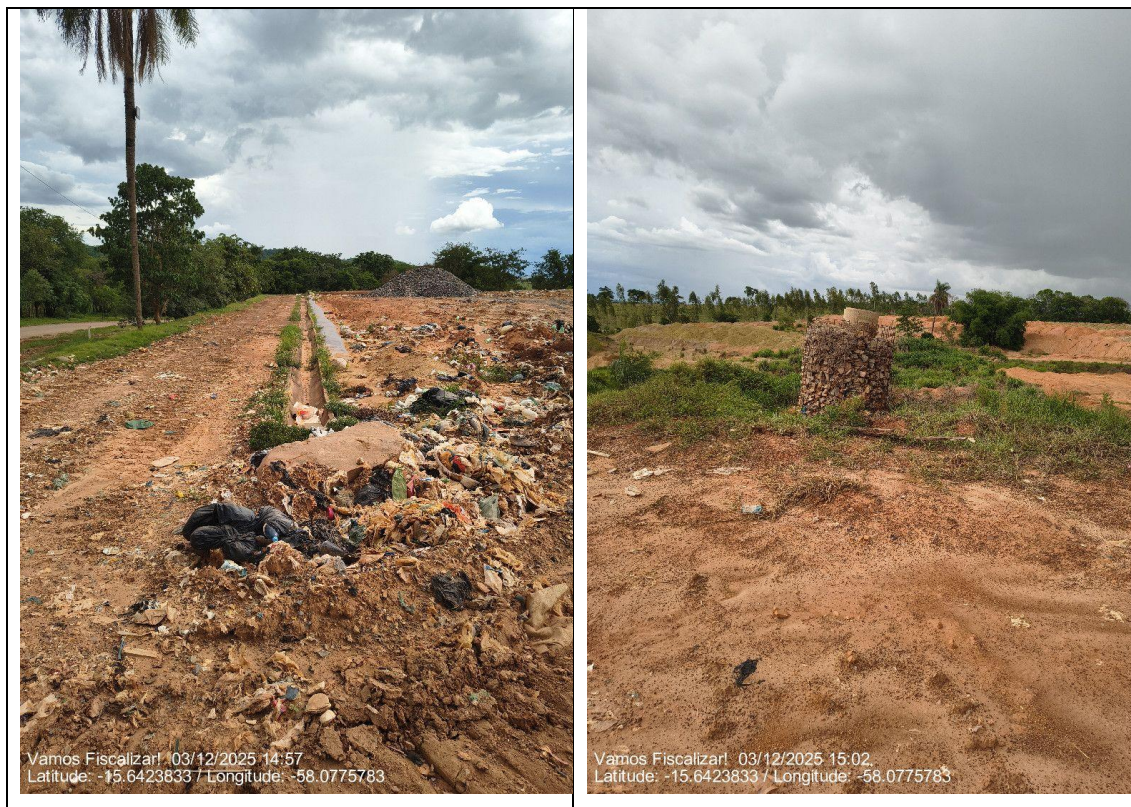
Figura 10 - FONTE: Fiscalização Agerr Pantanal (2025).
