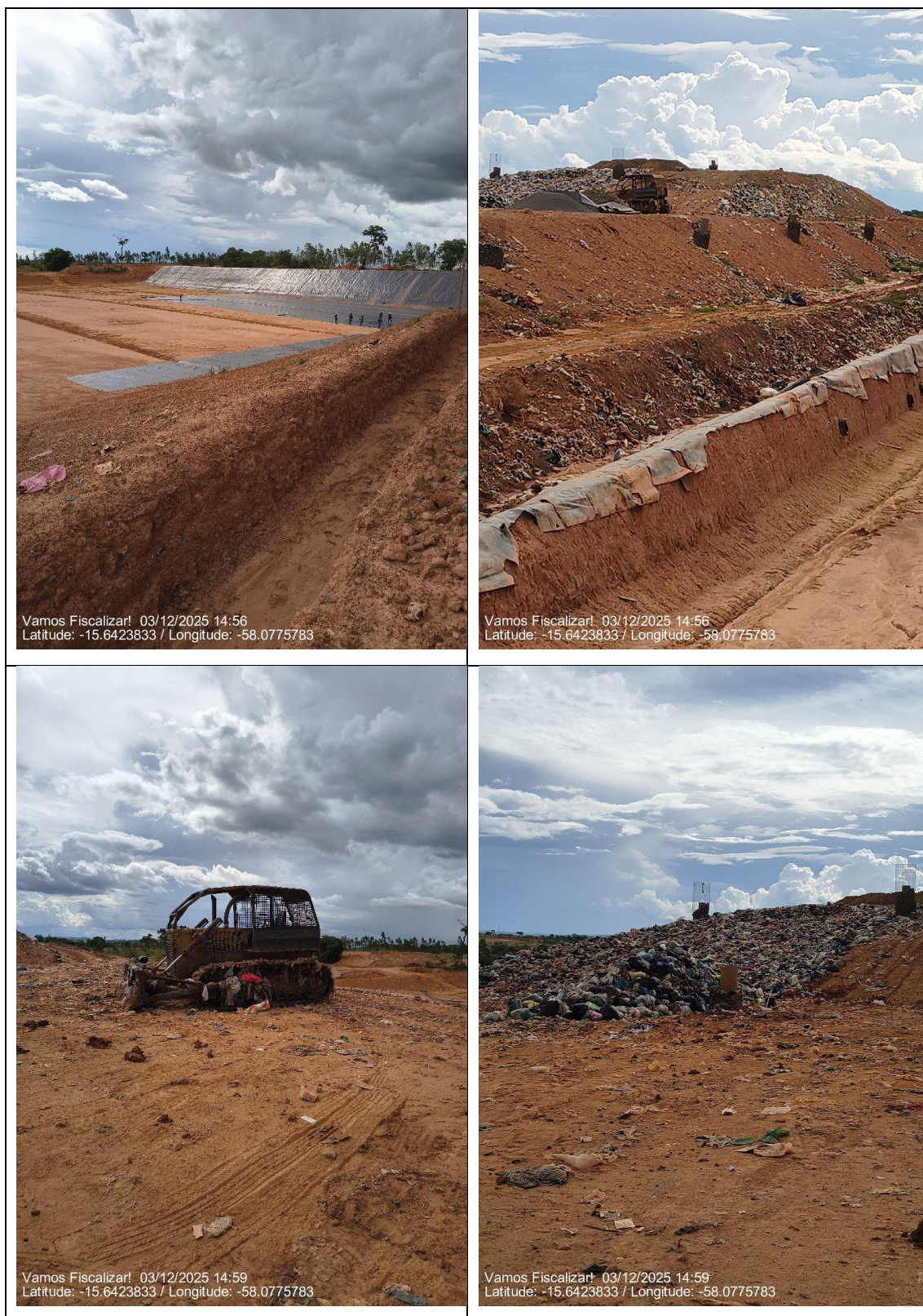
Figura 9 - FONTE: Fiscalização Agerr Pantanal (2025).
