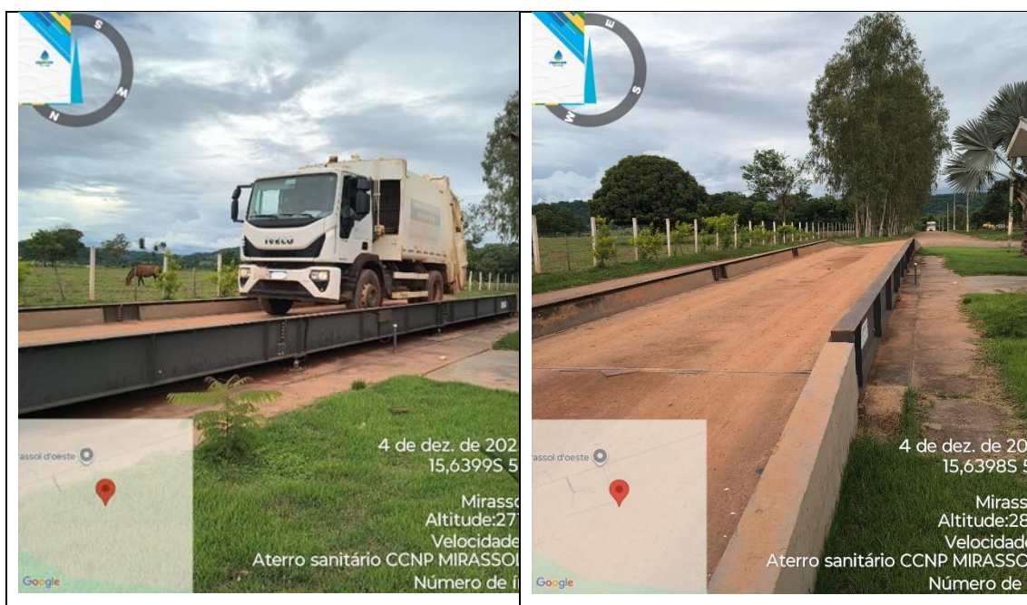
Figura 7 - FONTE: Fiscalização Agerr Pantanal (2025).
