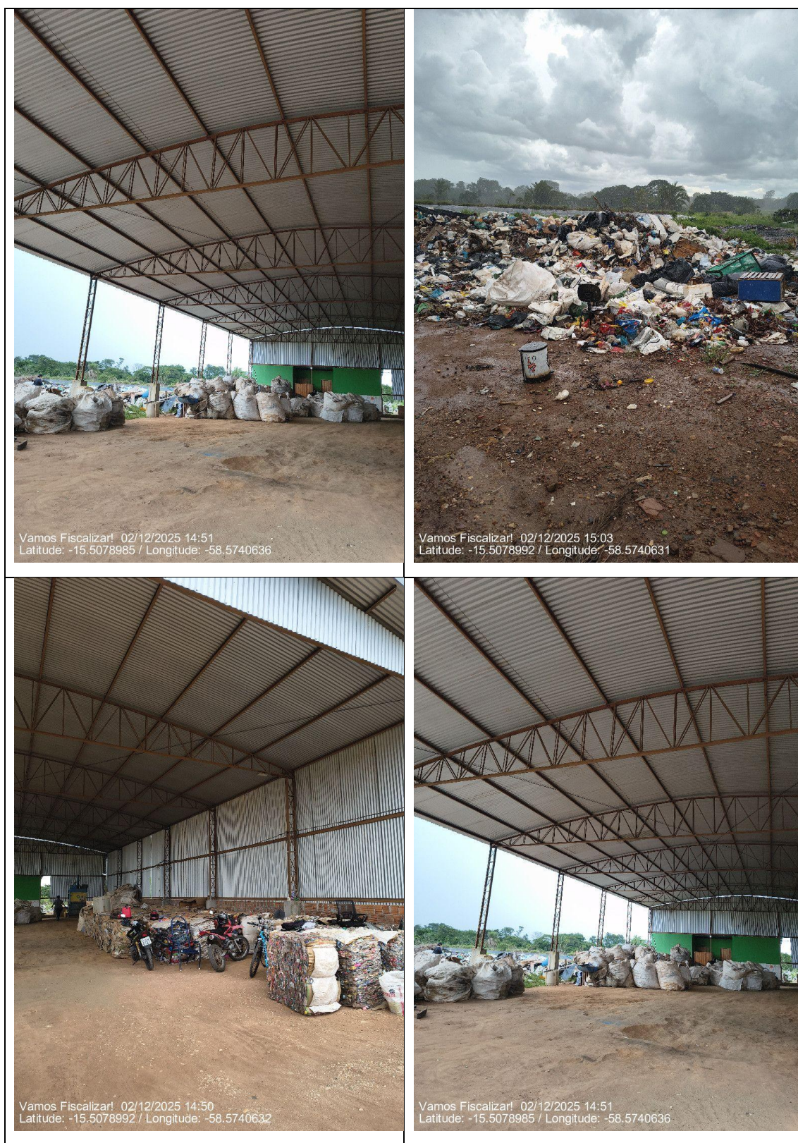
Figura 19 - FONTE: Fiscalização Agerr Pantanal (2025).
