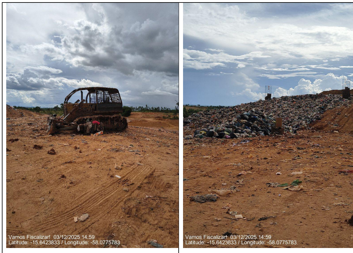
Figura 9 - FONTE: Fiscalização Agerr Pantanal (2025).
