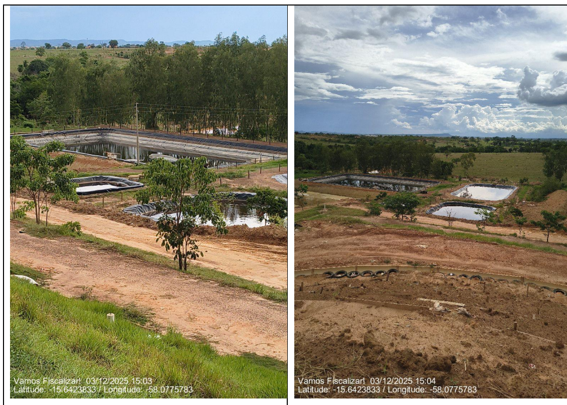
Figura 11 - FONTE: Fiscalização Agerr Pantanal (2025).
