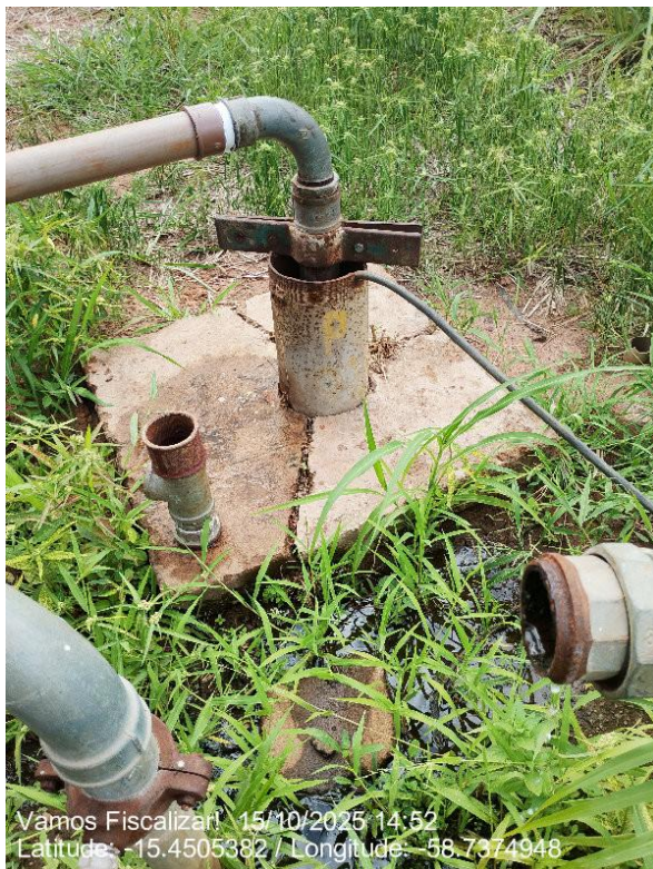
Com danos na estrutura
