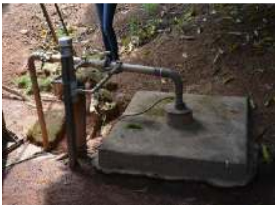
Figura 35 – Poço Tubular com clorador
