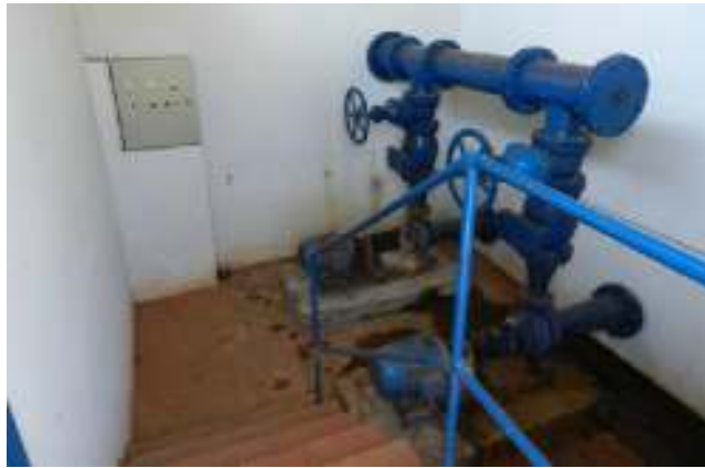
Figura 51 - Conjunto moto bomba
