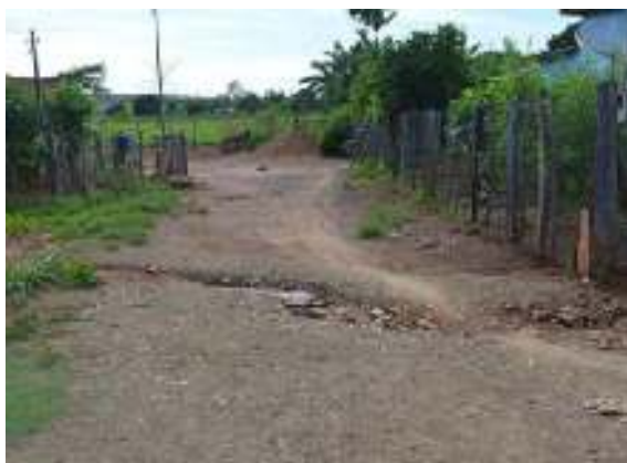
Figura 63- vista de erosão atravessando a via - moradores minimizando o problema
