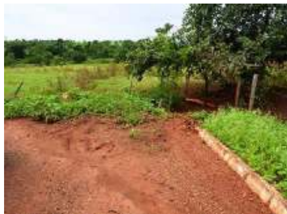
Figura 62 - Erosão em rua não pavimentada
