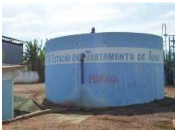
Figura 24 - Reservatório 300 m 3 , instalado na área da E.T.A
