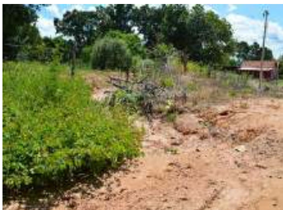
Figura 64 - Início de processo erosivo na lateral da via não pavimentada
