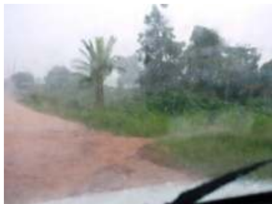
Figura 63 – Rua 7 de Setembro canal preferencial formado pelas águas das chuvas
