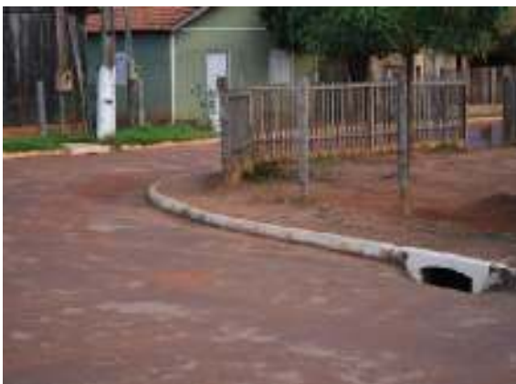
Figura 56 – Boca de lobo simples em via pavimentada São José do Pingador
