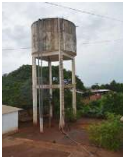
Figura 31– Reservatório de água
