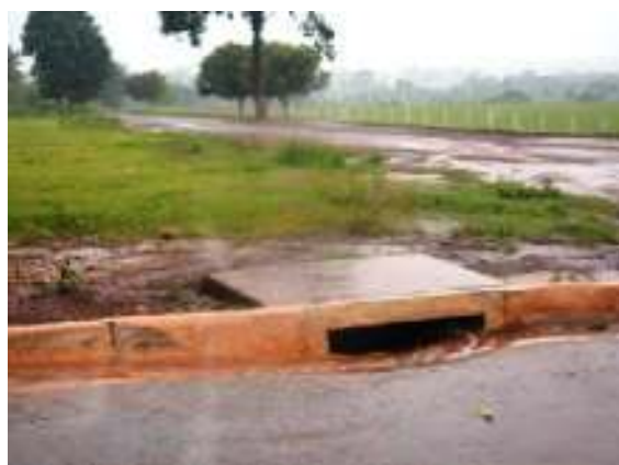
Figura 49 — Boca de lobo próximo ao ginásio
