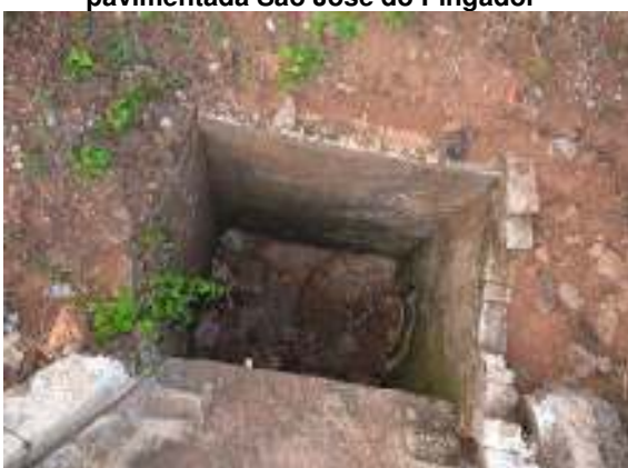
Figura 58 – Boca de lobo sem a tampa em condições precárias
