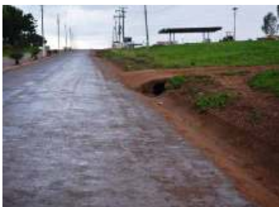
Figura 50 - Figura 29 – Drenagem Superficial As Margens Da MT 170 Sentido Curvelândia
