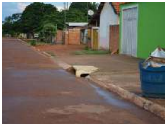
Figura 57 - Boca de lobo com duas entradas
