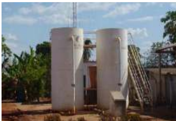
Figura 28 -- Sistema de tratamento de água Filtro Russo
