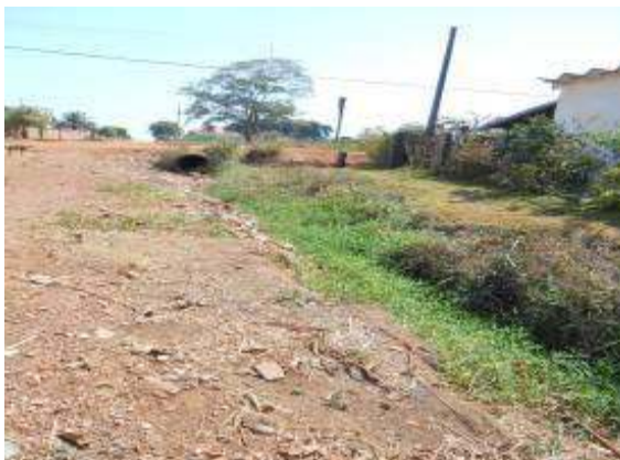
Figura 61 - Erosão em via não pavimentada causada pelo lançamento de águas pluviais sem a dissipação de energia.
