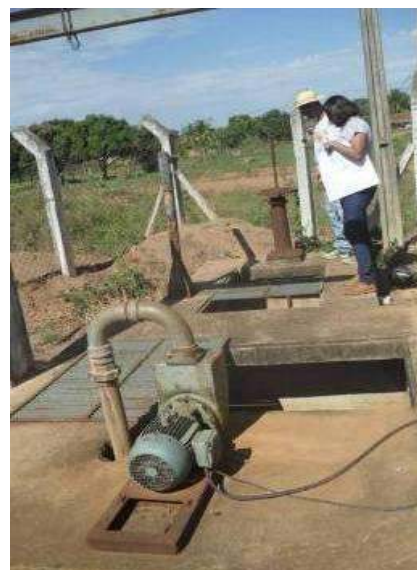
Figura 49 – Estação Elevatória II - Bairro Popular
