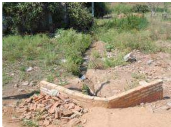
Figura 63 - Erosão em terreno causada pelo lançamento de águas pluviais sem a dissipação de energia.
