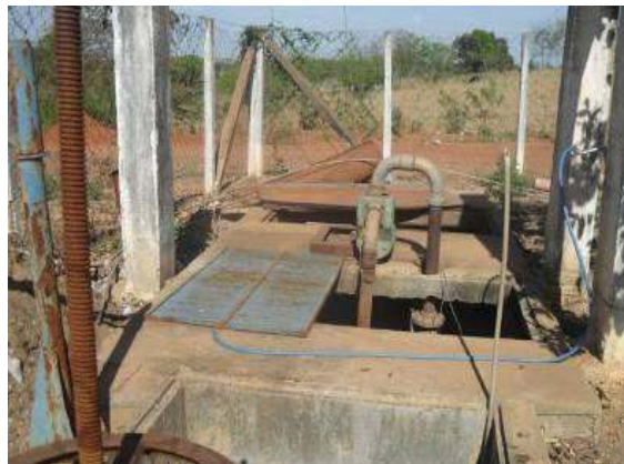
Figura 47 – Estação Elevatória I – Bairro Zeferino II
