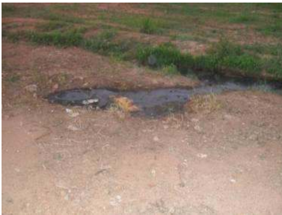
Figura 50 – Afloramento de esgoto - Estação Elevatória II
