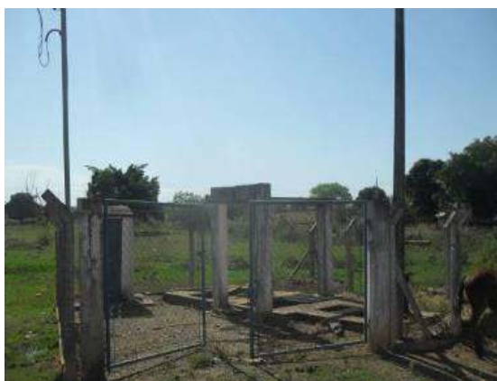
Figura 48 – Estação Elevatória II – Bairro Popular
