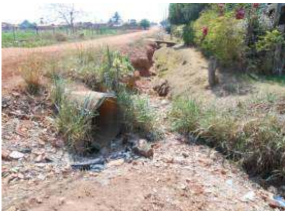
Figura 62- Erosão em via não pavimentada causada pelo lançamento de águas pluviais sem a dissipação de energia.
