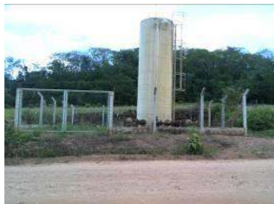
Figura 37 – Elevat. de Água Bruta 02.
