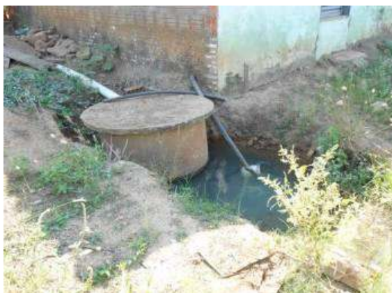
Figura 55 – Fossa séptica com vazamento.
