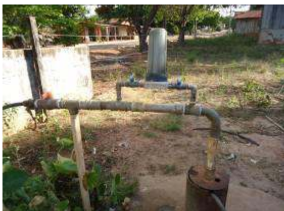
Figura 24 – Poço e clorador.
