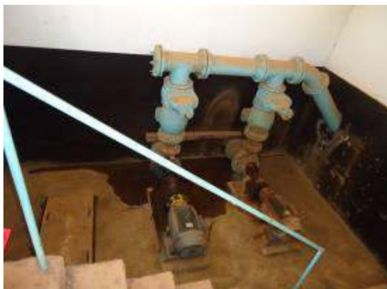
Figura 40 – Conjunto moto bomba.
