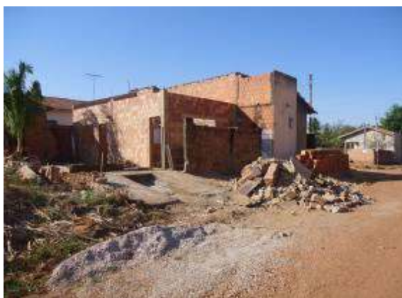
Figura 78 – RCD disposto em via pública não pavimentada – periferia da cidade.
