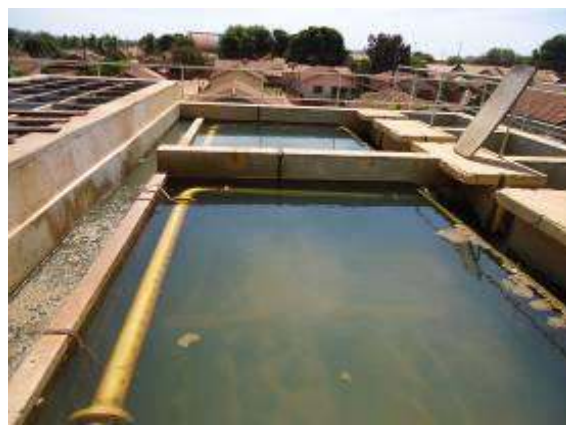
Figura 39 – ETA de concreto.
