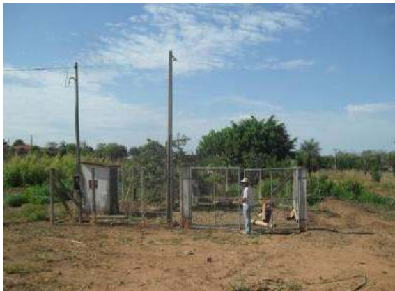
Figura 46 – Estação Elevatória I – Bairro Zeferino II
