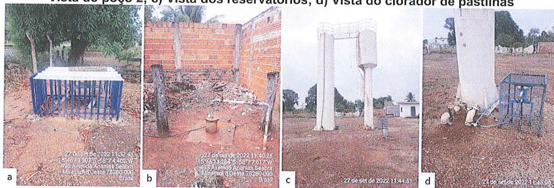
Figura 16: Registro fotográfico das unidades do sistema Sonho Azul: a) Vista do poço 1; b) Vista do poço 2; c) Vista dos reservatórios; d) Vista do clorador de pastilhas
