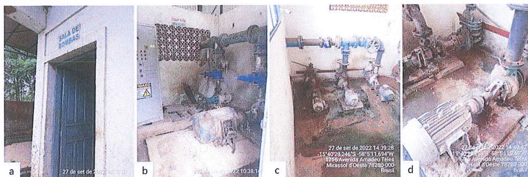
Figura 14: Registro fotográfico das EAT de Mirassol d'Oeste: a) Vista da entrada da EAT localizada no Parque da ETA; b) Vista dos GMB da EAT no Parque da ETA; c) Vista geral dos GMB da EAT localizada na praça São Paulo; e d) Vista em detalhe das instalações da EAT da praça São Paulo.
