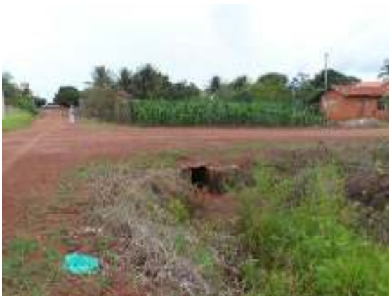
Figura 41 – Bueiro de cruzamento de águas pluviais na Rua João Cardoso
