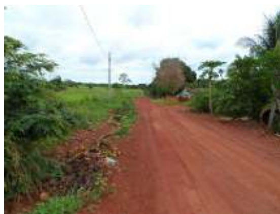
Figura 48 – Erosão em via não pavimentada causada pelo lançamento de águas pluviais sem a dissipação de energia.
