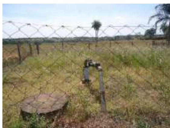
Figura 25 – Poço nº 6 Monte Castelo (desativado)
