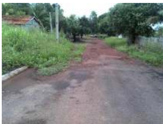
Figura 38 – Assoreamento de via após término do asfalto.
