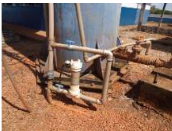
Figura 30 – Clorador - Monte Castelo
