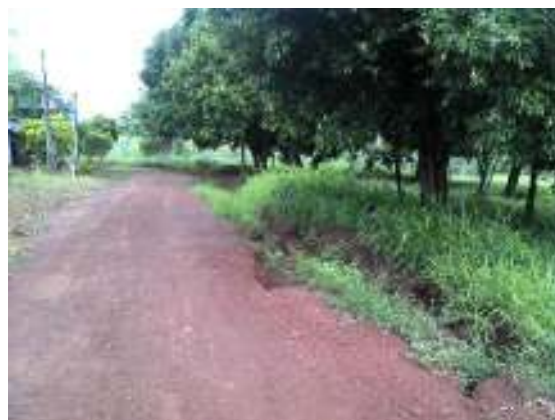
Figura 44 – Assoreamento causado pelas águas pluviais (Monte Castelo).
