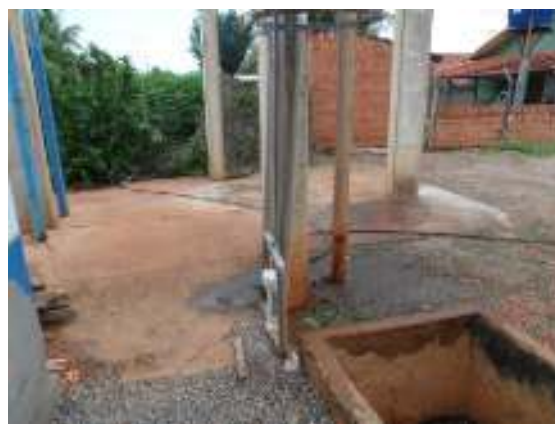
Figura 31 – Clorador - Área urbana
