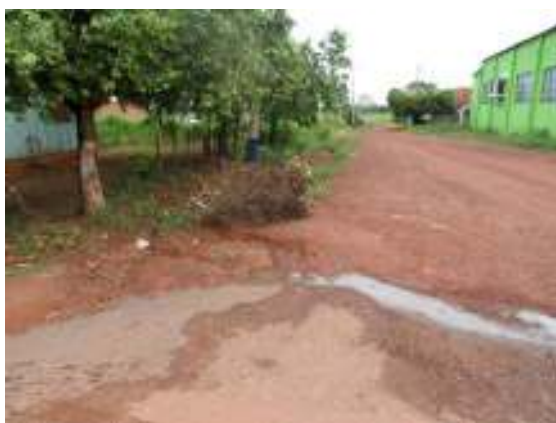
Figura 47 – Início de erosão em via não pavimentada.
