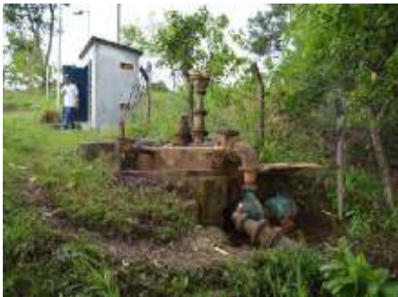
Figura 32 - Recalque da captação
