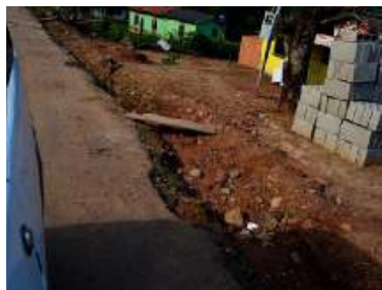
Figura 73– Pavimento sem meio fio e sarjeta início de processo erosivos na lateral da via.
