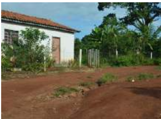
Figura 74– Início de ravinas em via não pavimentada.
