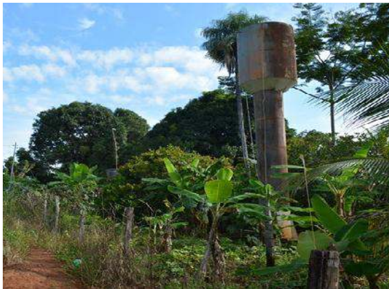
Figura 28 - Reservatório que abastece a Vila São Jorge
