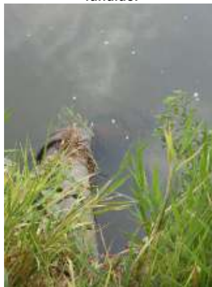
Figura 35 - Tubulação de sucção
