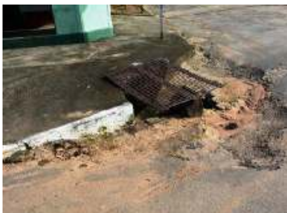
Figura 60 – Boca de lobo sem tampa e pavimento danificado
