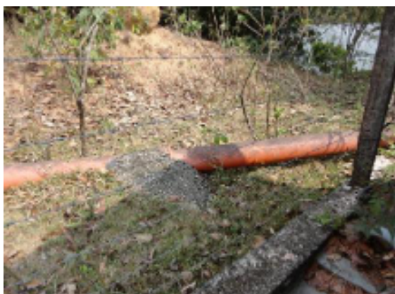
Figura 37 – Adutora de água bruta
