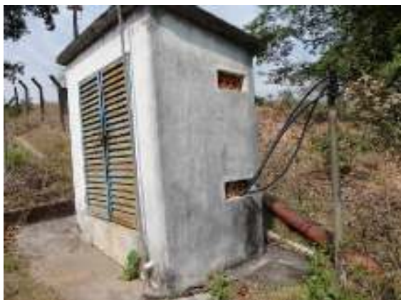
Figura 36 – Casinha para proteção quadro de comando da bomba
