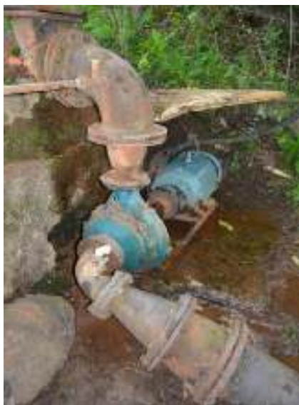
Figura 34 - bomba da captação
