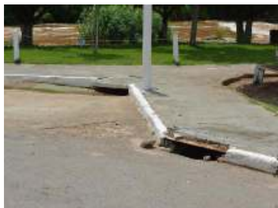
Figura 61 – Boca de lobo próximas da cachoeira
