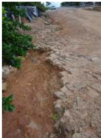
Figura 75– Início de processos erosivos em via não pavimentada.
