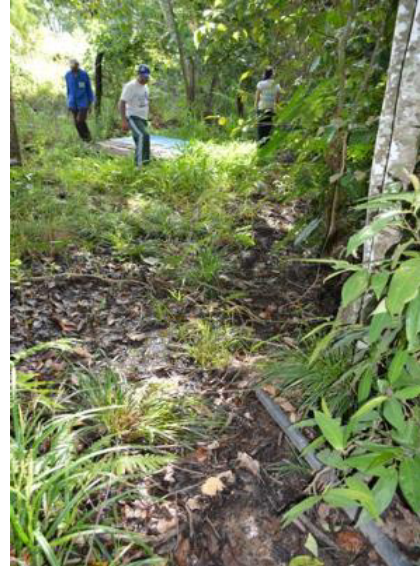
Figura 27 - Tubulação que liga a mina ao reservatório da Vila São Jorge.
