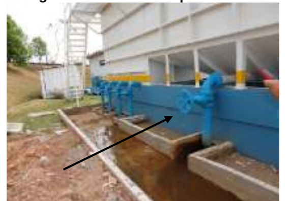
Figura 45– registro para descarga do lodo do decantador
