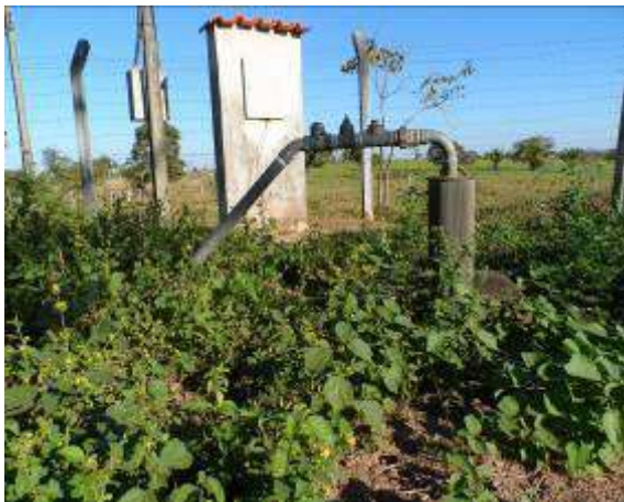
Figura 24 – Poço e quadro de comando.
