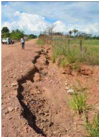
Figura 36- Erosão em via não pavimentada.
