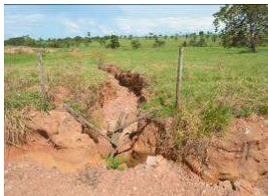
Figura 35 - Erosão causada pelo lançamento de águas pluviais (fim da microdrenagem) sem a dissipação de energia.
