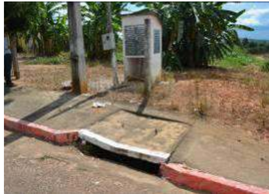
Figura 33– Boca de lobo com tampa cedendo.
