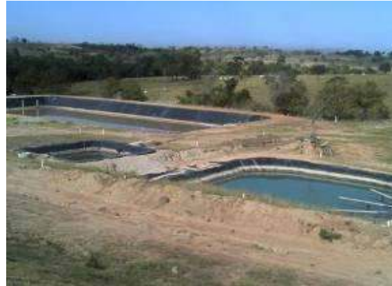
Figura 58 – Sistema de tratamento de chorume do aterro sanitário consorciado.
