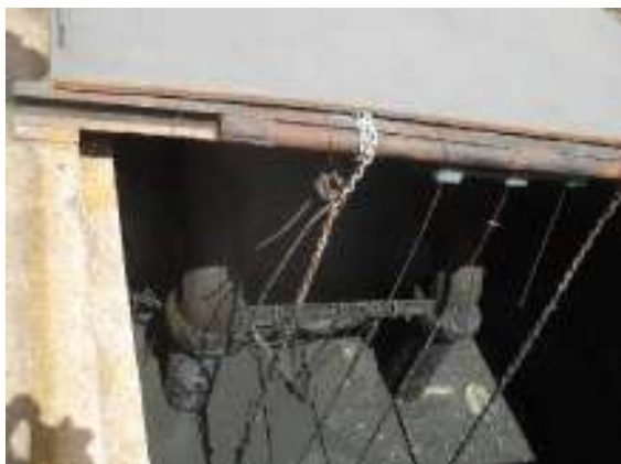
Figura 35 – Bombas Submersas - EEE – Bairro Jd Eldorado
