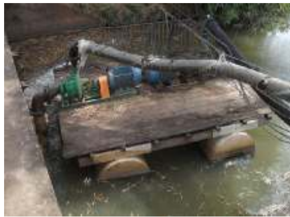
Figura 21 – Detalhe da Bomba e Flutuador.
