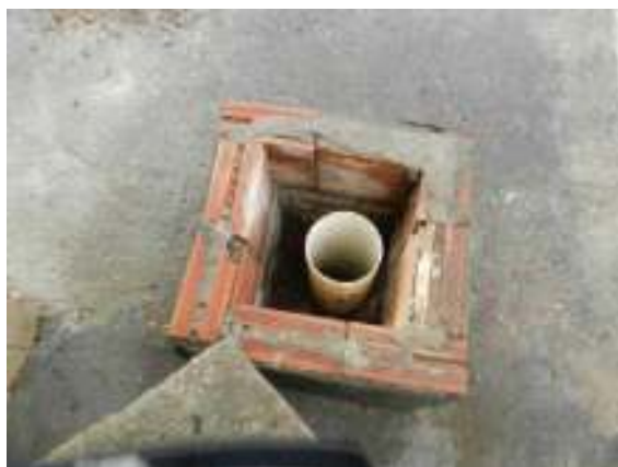
Figura 45 – Dispositivo de Limpeza da Fossa
