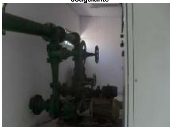
Figura 26 – Casa de Bombas
