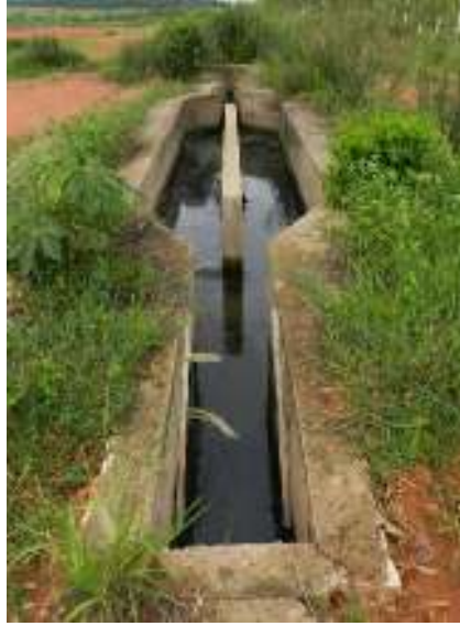
Figura 39 – Estação de Tratamento de Esgotos - Tratamento Preliminar – Desarenador e Calha Parshall
