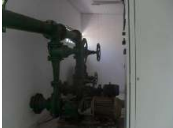
Figura 31 – Conjunto moto bomba.
