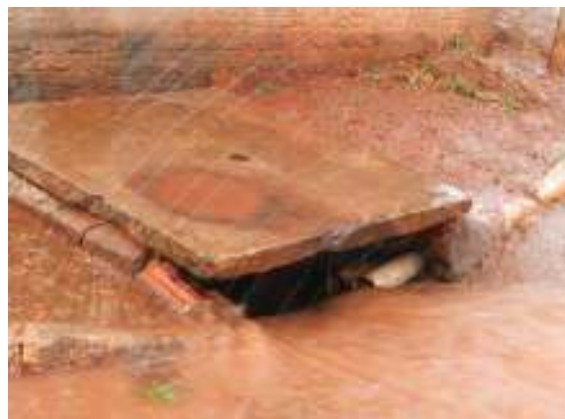
Figura 47 – Ligação clandestina de esgoto doméstico (Bairro cidade alta)
