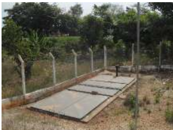
Figura 34 – Estação Elevatória - Bairro Jd Eldorado
