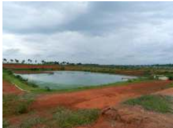
Figura 40 – Sistema de Tratamento de Esgoto – Lagoa facultativa I
