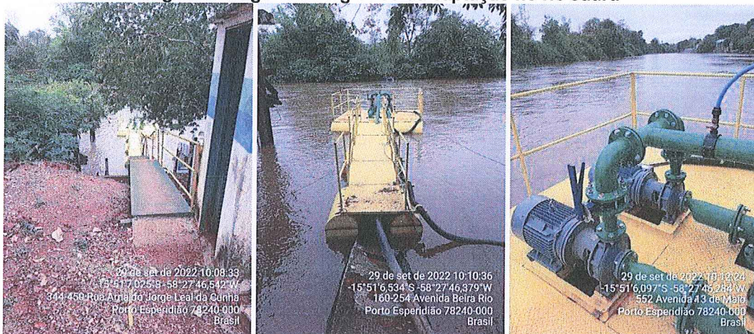
Figura 5: Registro fotográfico da captação no rio Jauru
