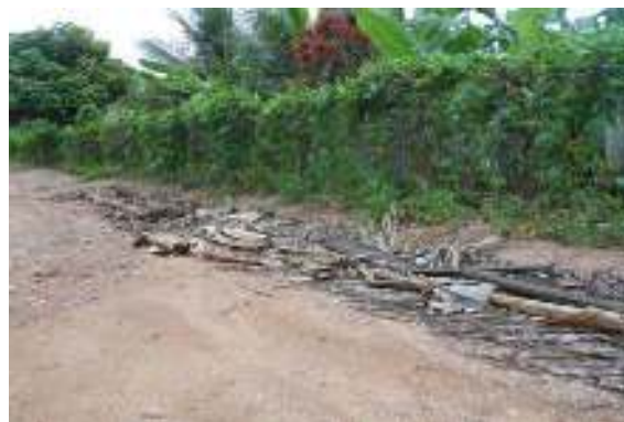
Figura 65 – Deposição de resíduos para amortização da erosão por moradores.
