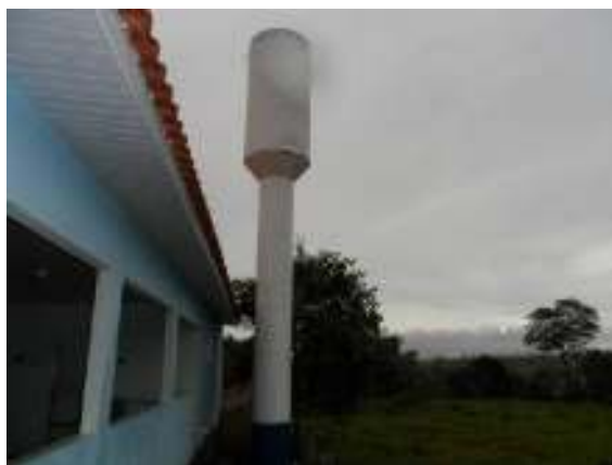
Figura 29 – Reservatório tipo Taça.
