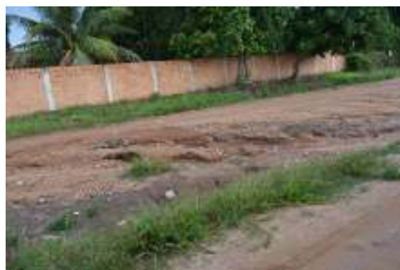
Figura 68 - Erosão em via não pavimentada causada pelo lançamento de águas pluviais sem a dissipação de energia
