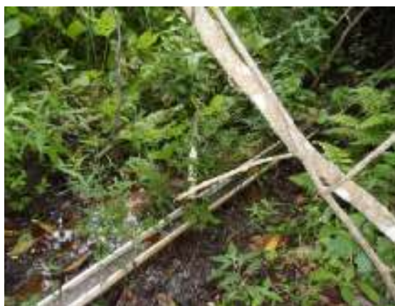
Figura 31 – Sistema de condução por gravidade para abastecimento.
