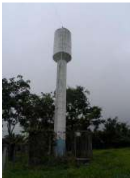
Figura 25 – Reservatório elevado tipo taça
