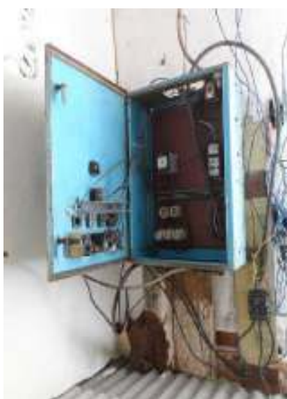
Figura 23 – Quadro de comando existente
