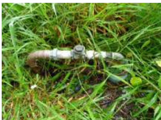
Figura 24 – Poço sem clorador.
