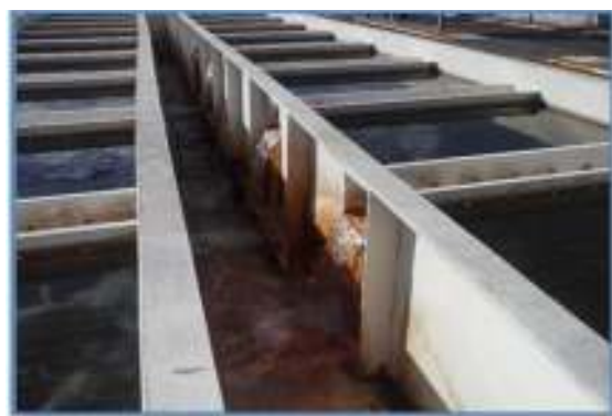
Figura 40: Decantador (FONTE: ÁGUAS DE JAURU)
