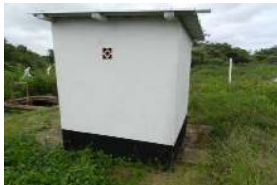
Figura 48 – Abrigo do Quadro de comando da EEE.
