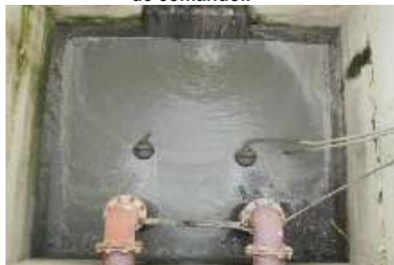
Figura 52 – Poço de Sucção da EEE.
