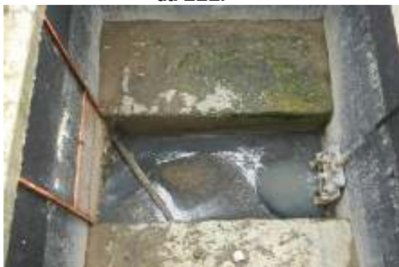
Figura 51 – entrada e gradeamento da EEE.
