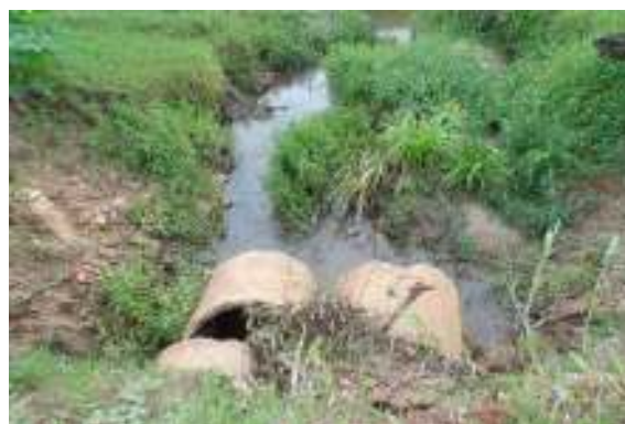
Figura 66 – bueiro danificado em Lucialva com processos erosivos .
