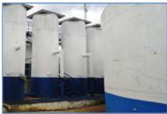
Figura 41: Filtros (fonte: águas de Jauru)
