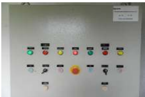
Figura 49 - painel de controle e acionamento da EEE.
