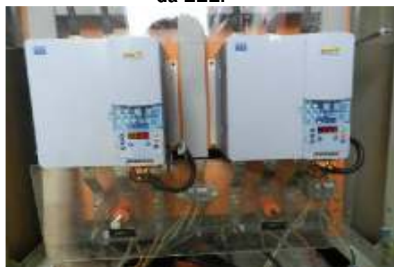
Figura 50 – Sistema “Soft Starter” do quadro de comando..
