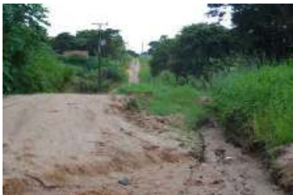
Figura 64 – Via em Matelândia com processos erosivos .
