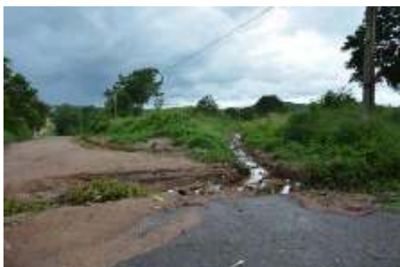
Figura 67 - Início de processo erosivo em via não pavimentada.
