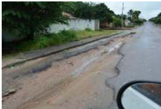
Figura 70 - Erosão em terreno causada por abertura de vala para instalação de rede de esgotamento
