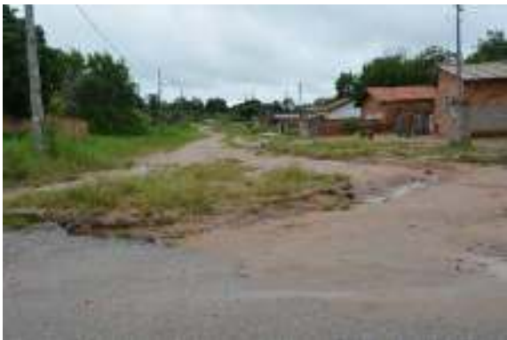
Figura 69 - Erosão em via não pavimentada causada pelo lançamento de águas pluviais sem a dissipação de energia.
