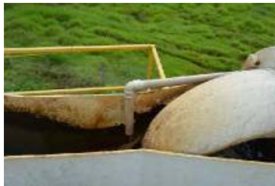
Figura 39 – Ponto de aplicação do coagulante – ressalto hidráulico (calha Parshall).
