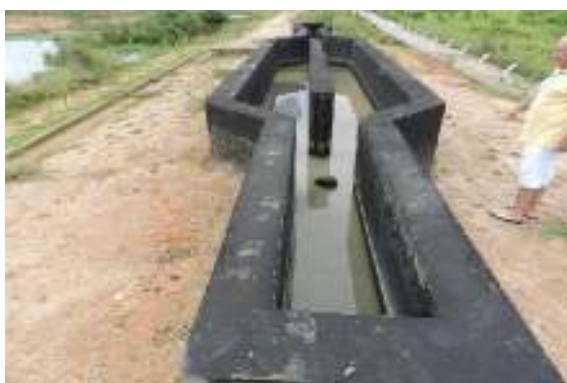
Figura 55 – Chegada do Efluente na ETE, Calha Parshall e desarenador.
