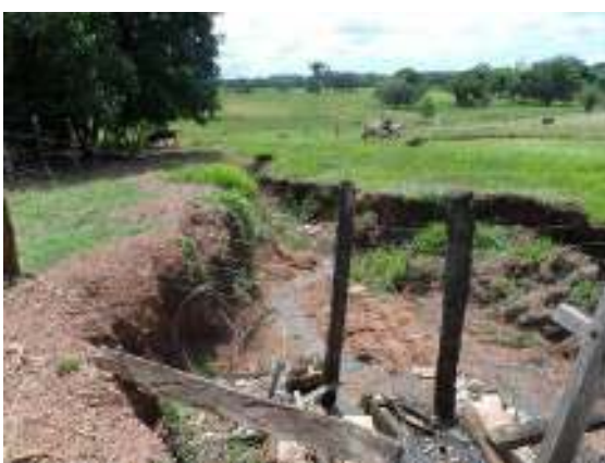
Figura 48 – Erosão em área urbana – fim de drenagem superficial
