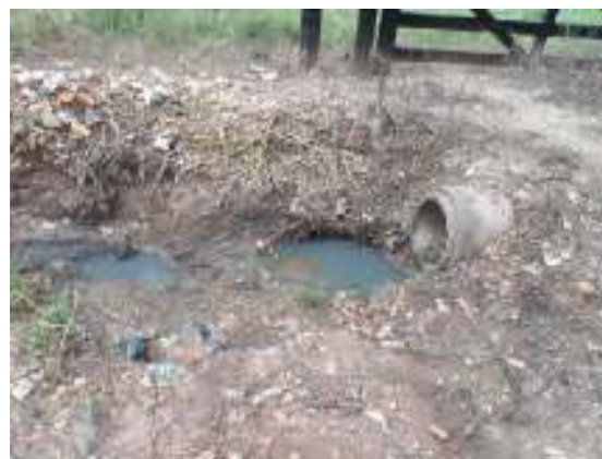
Figura 36 –esgoto a céu aberto
