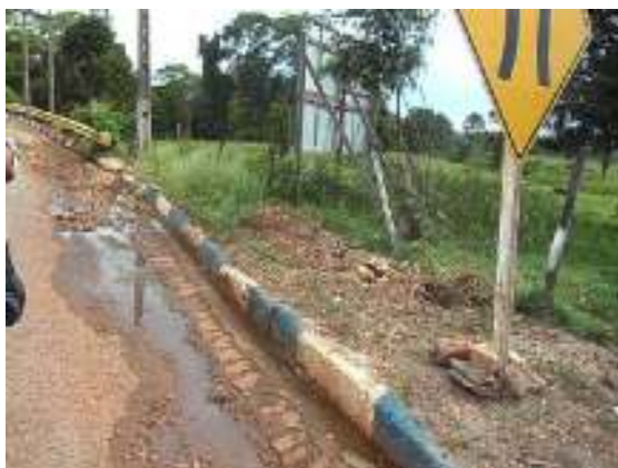
Figura 38 – Escoamento superficial direcionado para o córrego
