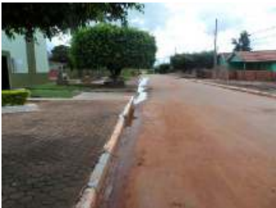
Figura 46 – Escoamento oriundo de áreas com lençol aflorante
