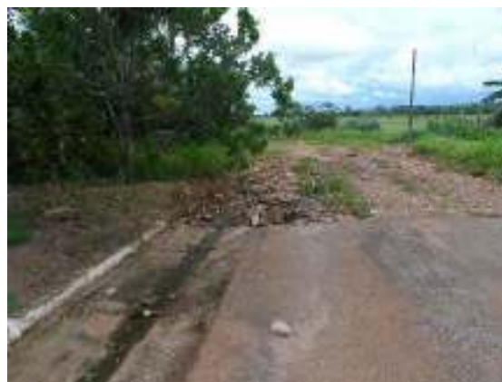
Figura 39 – Escoamento superficial no término de via pavimentada
