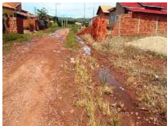
Figura 45 – Rua com lençol freático aflorante
