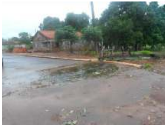
Figura 47 – escoamento de águas pluviais ligada a rede coletora de esgoto
