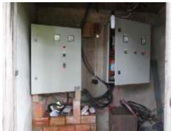
Figura 25 – Quadro de comando
