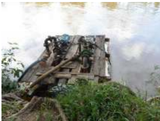
Figura 24 – Captação no Rio Jauru
