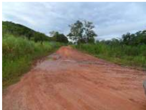
Figura 51 – pontos de estrangulamento, ausência de drenagem em estrada vicinal
