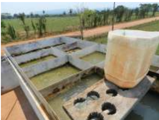
Figura 85 – Dosador improvisado de sulfato de alumínio
