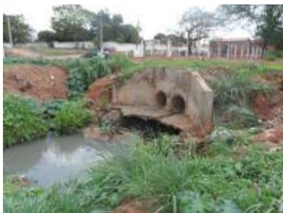
Figura 100– Esgoto escoando para o Córrego André
