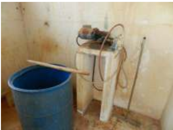
Figura 89 – Bomba dosadora de cloro queimada
