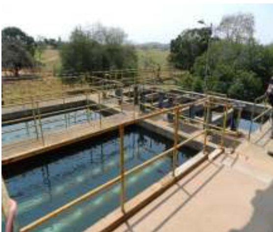
Figura 44 – ETA decantação e filtração.
