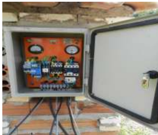
Figura 78 – Painel de comando do poço
