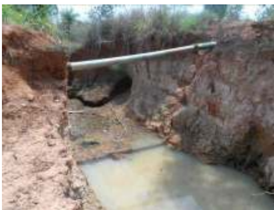
Figura 112 - Erosão causada pelo transbordamento de águas pluviais (barragem) sem a bueiro ou vertedouro.
