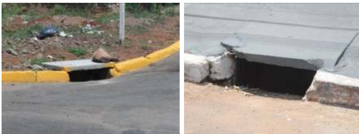
Figura 106 – Bocas de lobo.
