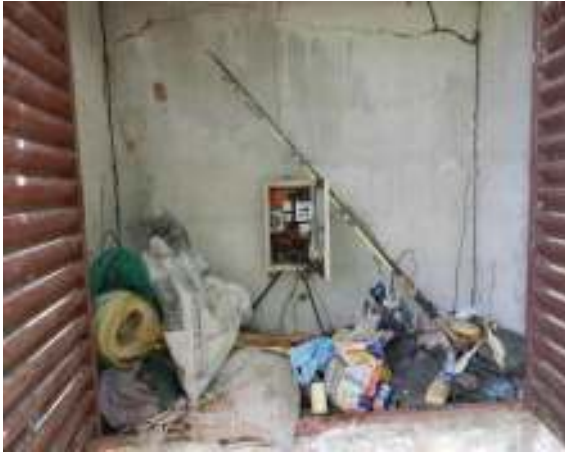
Figura 83 – Painel de comando
