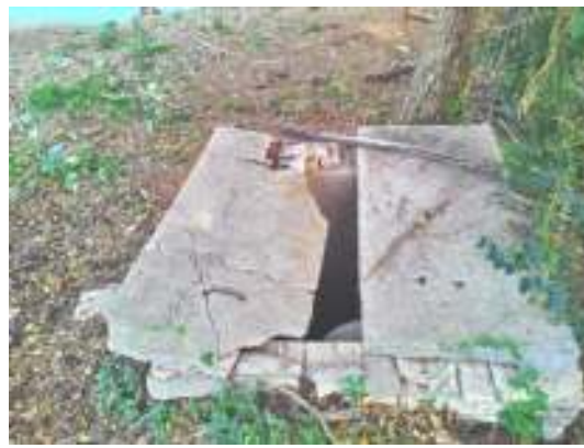
Figura 102 – Caixa de passagem na ETE danificada
