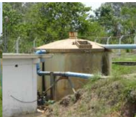
Figura 49 – Reservatório 250m³ (ETA) - concreto apoiado
