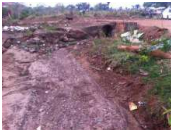
Figura 114 - Erosão causada pelo lançamento de águas pluviais (fim da microdrenagem) sem a dissipação de energia.
