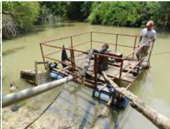
Figura 82 – Captação superficial tipo flutuante
