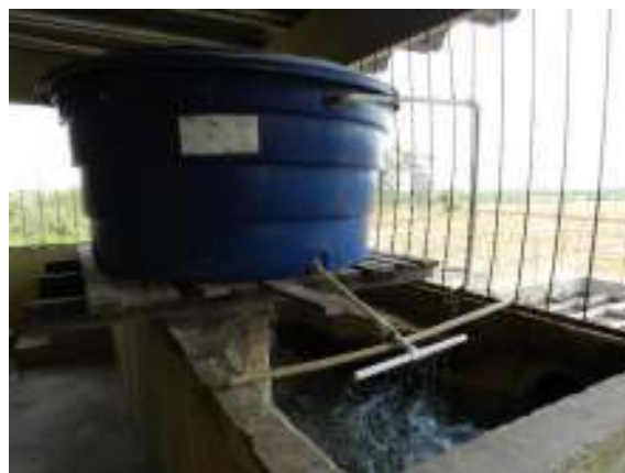
Figura 47 – Dosador de sulfato de alumínio
