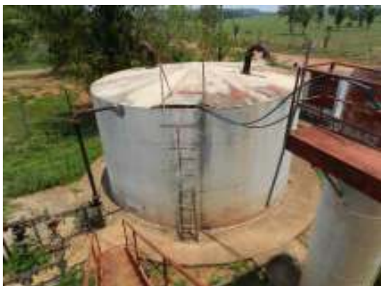
Figura 91 – Reservatório de 30m 3
