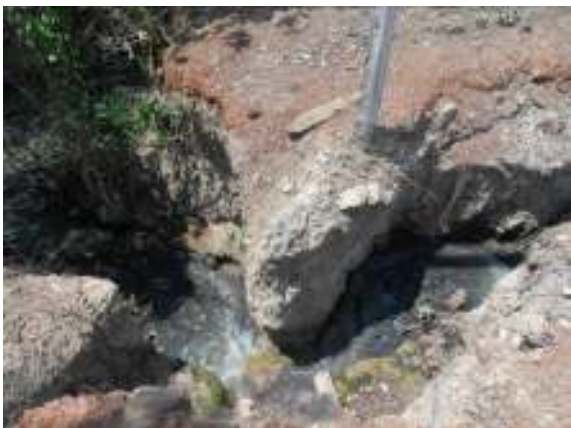
Figura 113 - Erosão em em beira de córrego pela extravazão de E.E.E.
