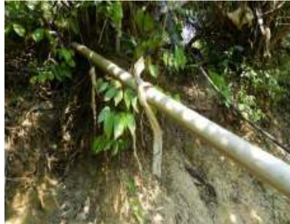
Figura 84 – Adutora água bruta
