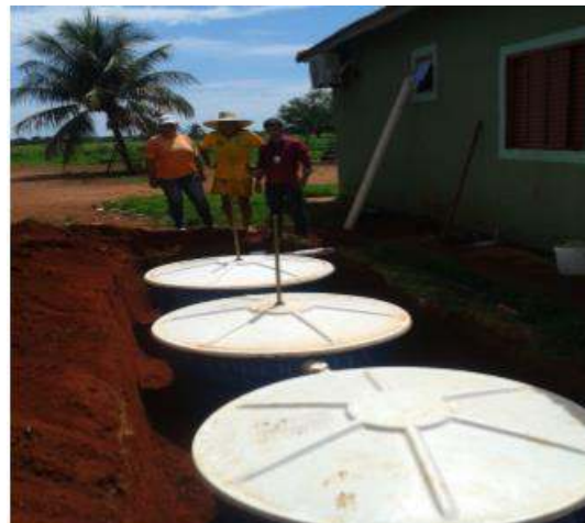
Figura 104 – Kit biofossa instalado
