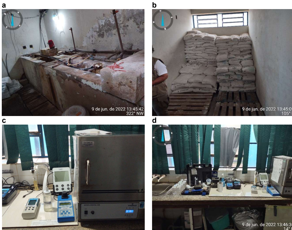
Figura 11: Registro fotográfico da casa de química e laboratório da ETA: a) Vista dos tanques de diluição; b) Vista do estoque de produto químico coagulante (sulfato de alumínio) c) Vista dos aparelhos de análise de água peagâmetro, colorímetro, turbidímetro e estufa; d) Vista geral da bancada de análise do laboratório.
