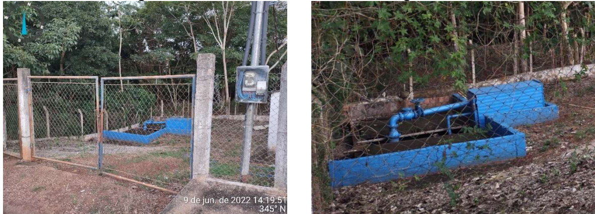
Figura 17: Vista da estação elevatória de esgoto bruto;
