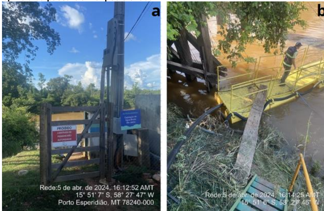
Figura 1: Registros realizados do ponto de captação: a) identificação da unidade; b) Vista da passarela mal posicionada.
