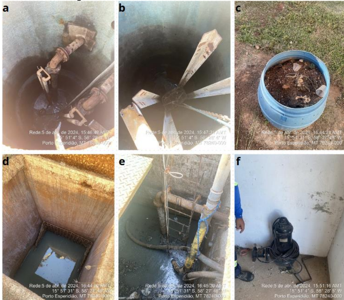
Figura 5: Registro das EEB do SES de Porto Esperidião: a) Vista poço de sucção EEB Nova; b) Vista do cesto coletor da EEB Nova; c) Sólidos Removidos EEB Velha; d) Caixa de gradeamento EEB Velha; e) Vista EEB Velha; f) Bomba fria utilizada em emergências.
