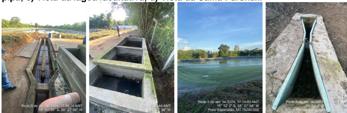
Figura 6: Registros fotográficos da ETE de Porto Esperidião: a) Vista da chegada de esgoto bruto pelo desarenador; b) Vista da caixa de descarga dos caminhões pipa; c) Vista da lagoa facultativa; d) Vista da Calha Parshall.
