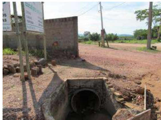
Figura 69 - Erosão em terreno causada pelo lançamento de águas pluviais sem a dissipação de energia.
