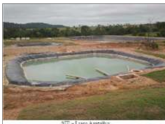
Figura 87 – Sistema de Tratamento de Efluente – Lagoa Anaeróbia
