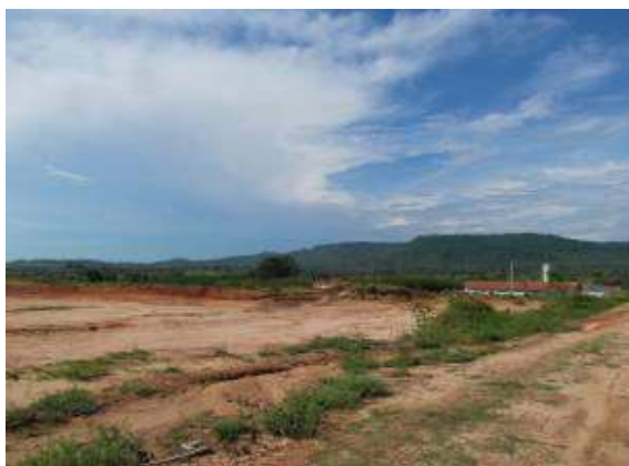
Figura 66- Início de erosão em via não pavimentada com declividade acentuada
