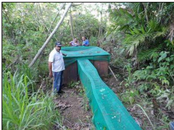
Figura 22 - Calha Parshal (medidor de vazão) e Reservação.
