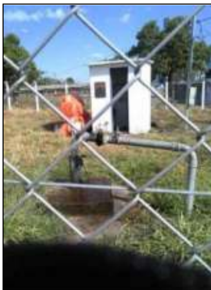
Figura 24 - Poço Tubular - Comunidade Casulo Mulher
