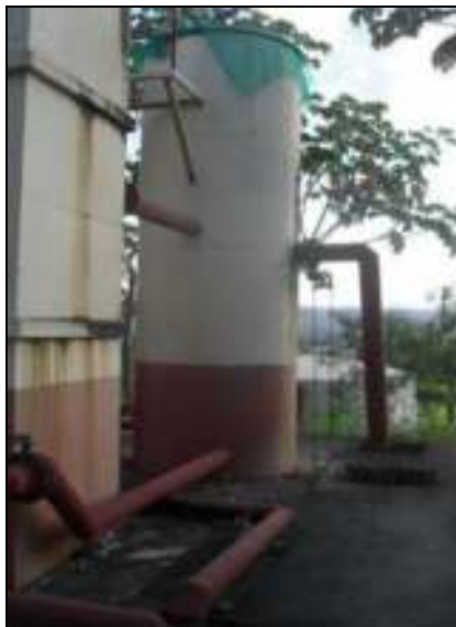
Figura 28 - Filtros e Clorador (pré tratamento)
