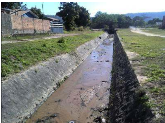
Figura 60 - Drenagem no ponto mais baixo da cidade
