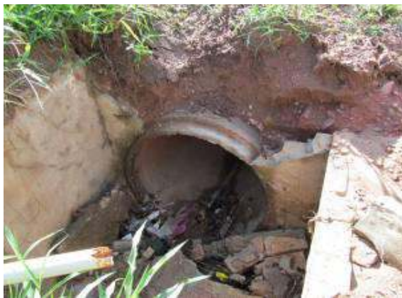
Figura 68 - Erosão em via não pavimentada causada pelo lançamento de águas pluviais sem a dissipação de energia.
