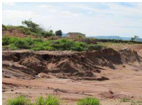
Figura 67 - Erosão em via não pavimentada causada pelas chuvas pela falta de drenagem.
