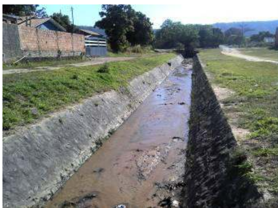
Figura 65–Drenagem principal da cidade – Reserva do Cabaçal
